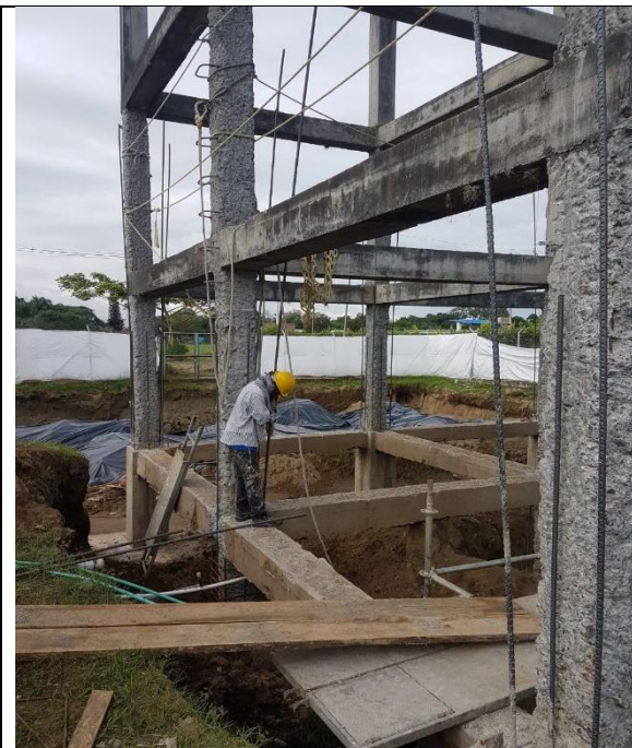
PROCESO DE ESCARIFICACION Y REFORZAMIENTO DE LA ESTRUCTURA DEL TANQUE DE ALMACENAMIENTO
