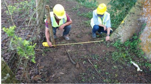
Replanteo en terreno de línea de aducción. Medida de separación con árbol existente (Ceiba) FECHA: 10/05/2018
